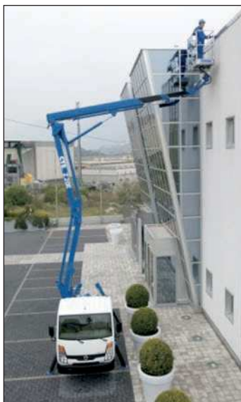
Piattaforma di lavoro mobile elevabile autocarrata (B1)
